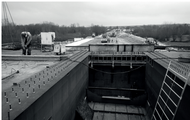
Prace nad budową drogi zjazdowej i dojazdowej do obiektu od strony województwa lubelskiego (fot. Tomasz Śliwka)
