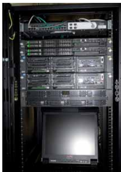
Widok serwerów zamontowanych w szafie komputerowej (fot. B. Wit)
