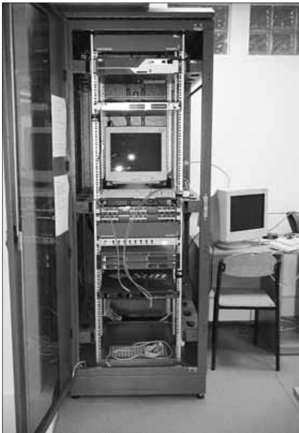
Sprzęt sieciowy w Laboratorium Technologii Multimedialnych i Sztucznej Inteligencji
