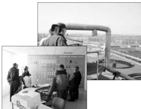
Hajdów – sterownia i widok z lotu ptaka
